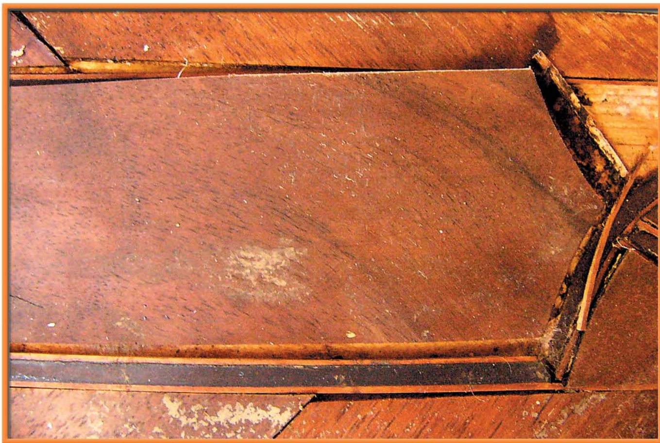
Deformace dýhy na pilastru způsobená vlhkostí.
