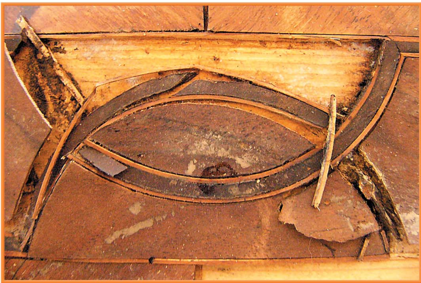
Detail pilastru - silně poškozená pásková intarsie - javorová linka místy sbroušena na sílu 0,4 mm tmavý pásek z připalované hrušně byl lokálně zcela degradován.
