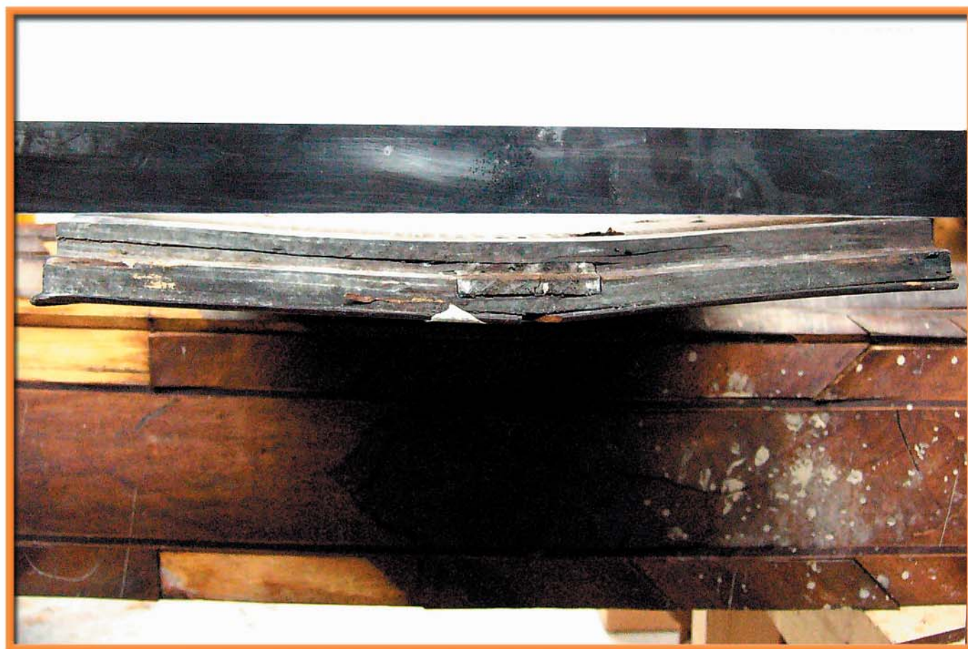
Deformace dvířek ve svislém směru.
