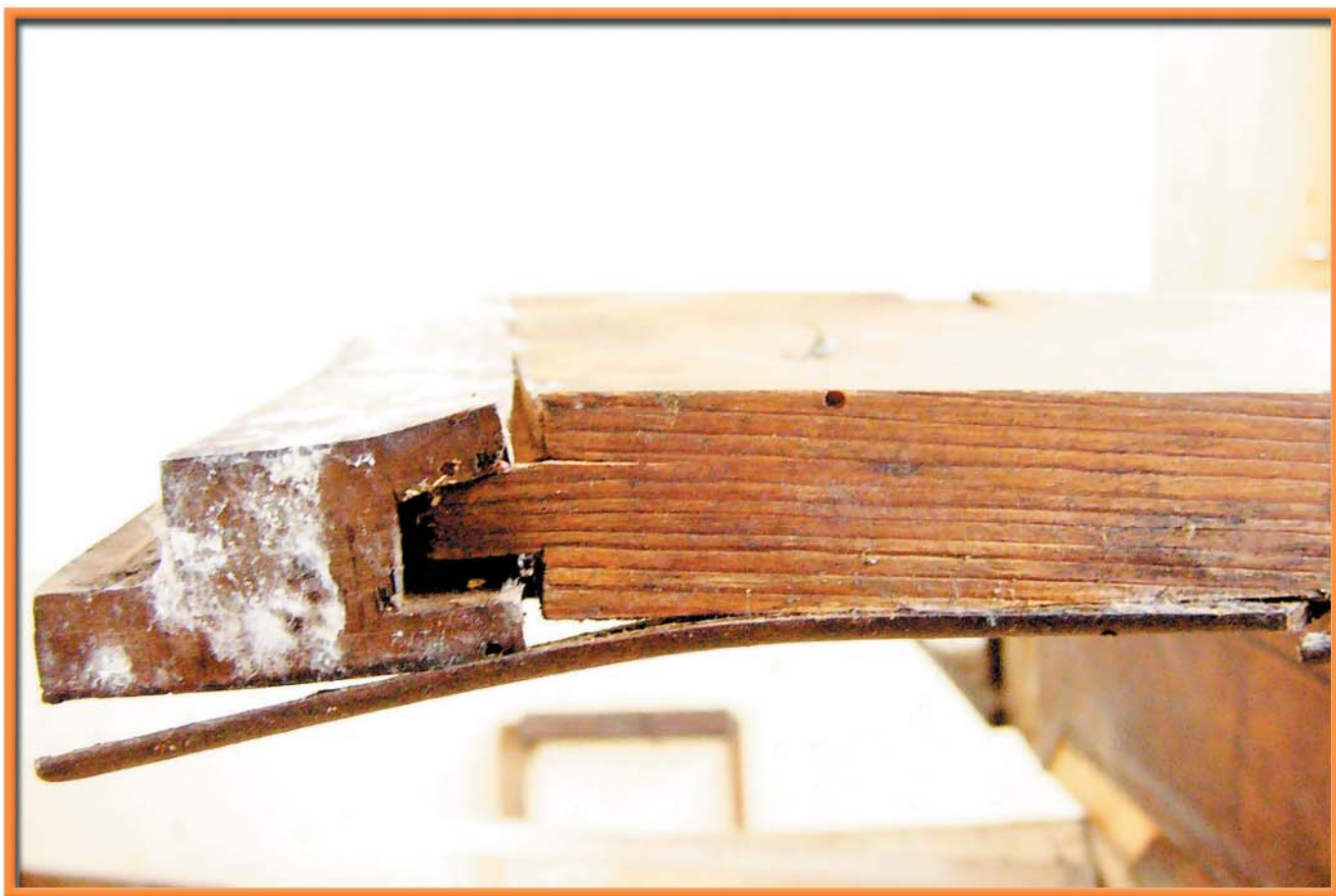
Deformace dvířek ve vodorovném směru.
